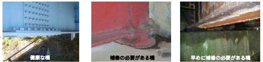
橋の損傷写真(例)
