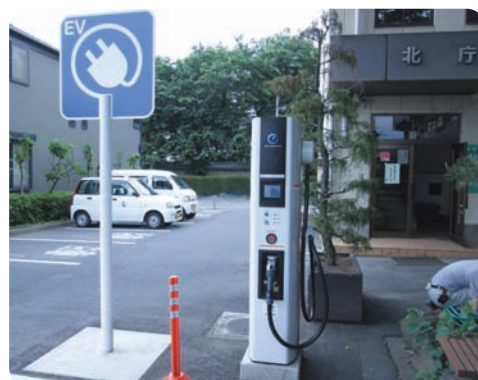
電気自動車用充電器の設置（市役所本庁舎）
