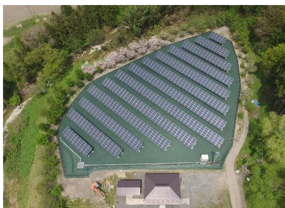
佐山太陽光発電所 (出力 291.5kW)
