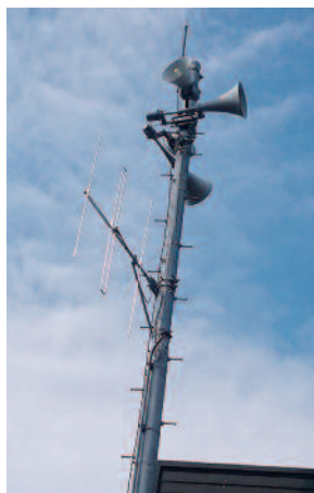
廃止される利根町防災行政無線
