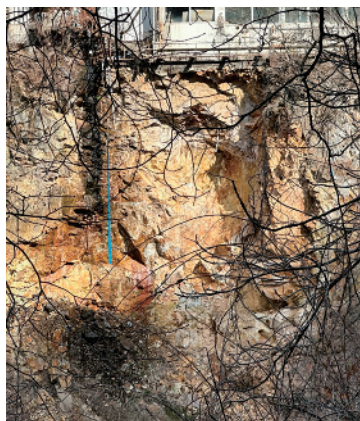
老神温泉、崩落危険箇所の様子
