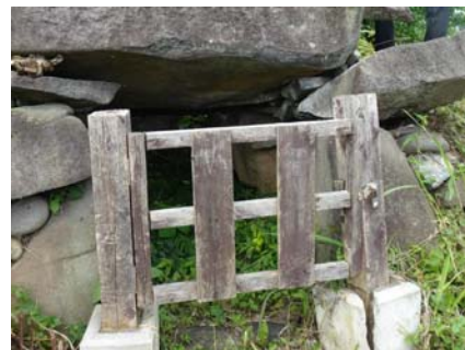
立入禁止柵の基礎の破損
