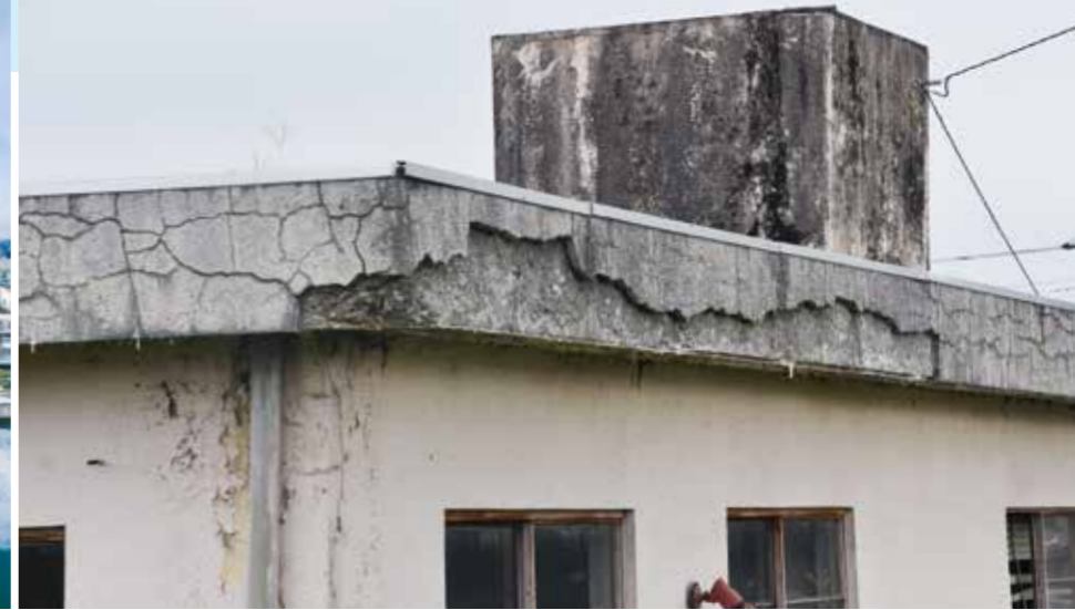
建物が老朽化して一部崩壊している
