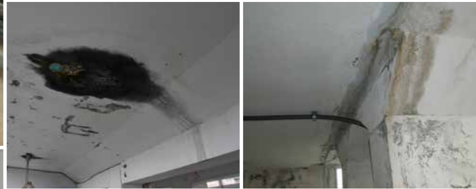
建物に亀裂が入り、雨漏りしている
