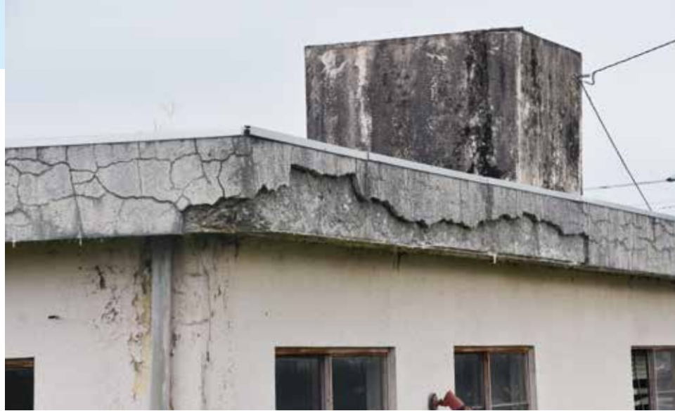
建物が老朽化して一部崩壊している
