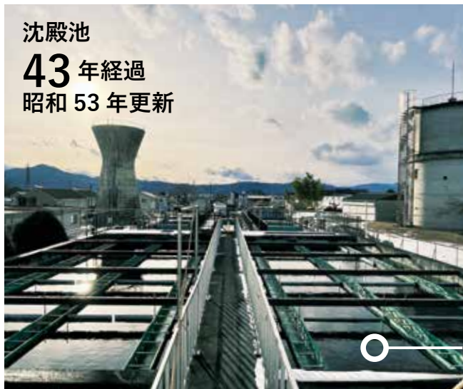
沈殿設備が変形し、供給能力が低下している
