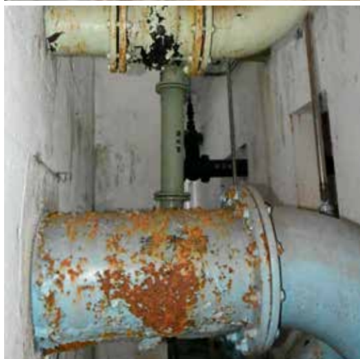
管の表面にさびが発生
