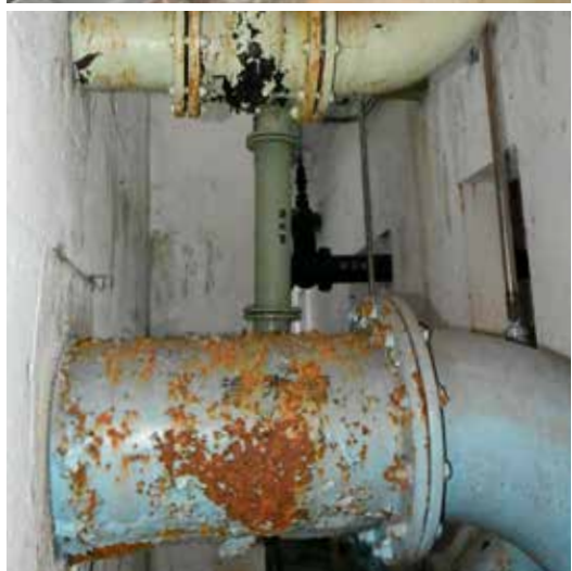
管の表面にさびが発生
