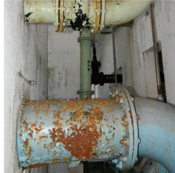
管の表面にさびが発生
