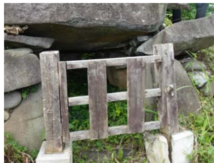
立入禁止柵の基礎の破損
