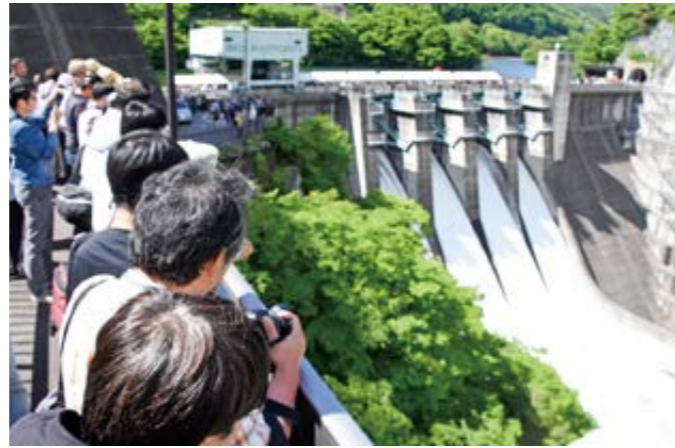
菌原湖堰堤まつりを初開催 菌原ダムの点検放流に合わせて、菌原湖堰堤まつりを初開催。約 1,900 人が来場しました。
