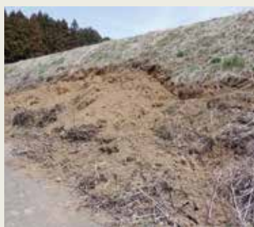
イノシシがエサを求めて掘り返し、草が剥がれ土がむき出しになっている
