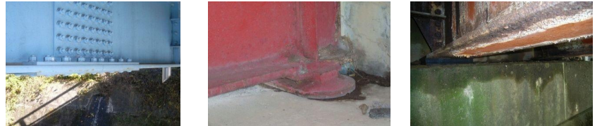
橋の損傷写真(例)
